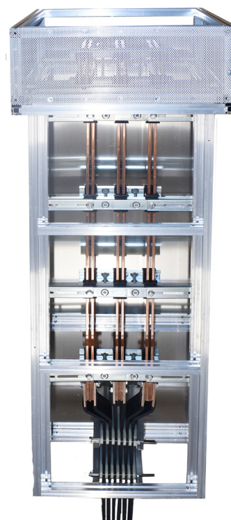
Erilink i kombination med Flexibar gör anslutningen av transformatorer enkel och flexibel.
